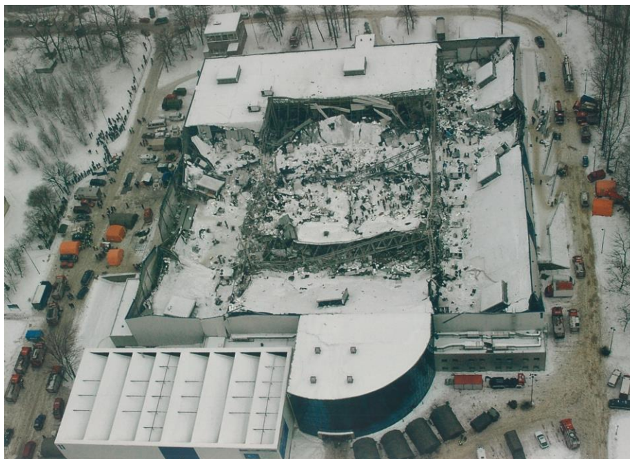
Rys. 1. Widok zawalonego w dniu 27 stycznia 2006 r. pawilonu nr 1 MTK Źródło: akta sprawy XVI K 133/08 E.P Sądu Okręgowego w Katowicach
