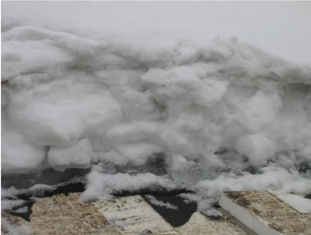
Rys. 3. Pokrywa śnieżno-lodowa udokumentowana na dachu pawilonu nr 1 MTK w 2006 r. Źródło: badania własne [1]
